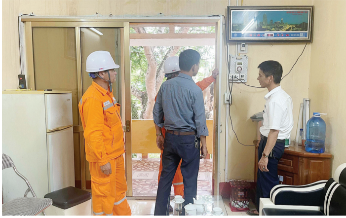
Điện lực thành phố Bắc Kạn kiểm tra hệ thống điện tại Trường THPT Bắc Kạn.
